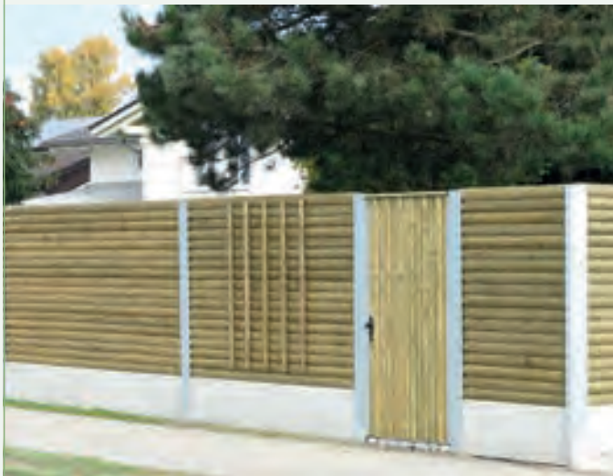
Reflektierende Rundholz-Lärmschutzwand Nr. 58.1 mit Betonteilen
