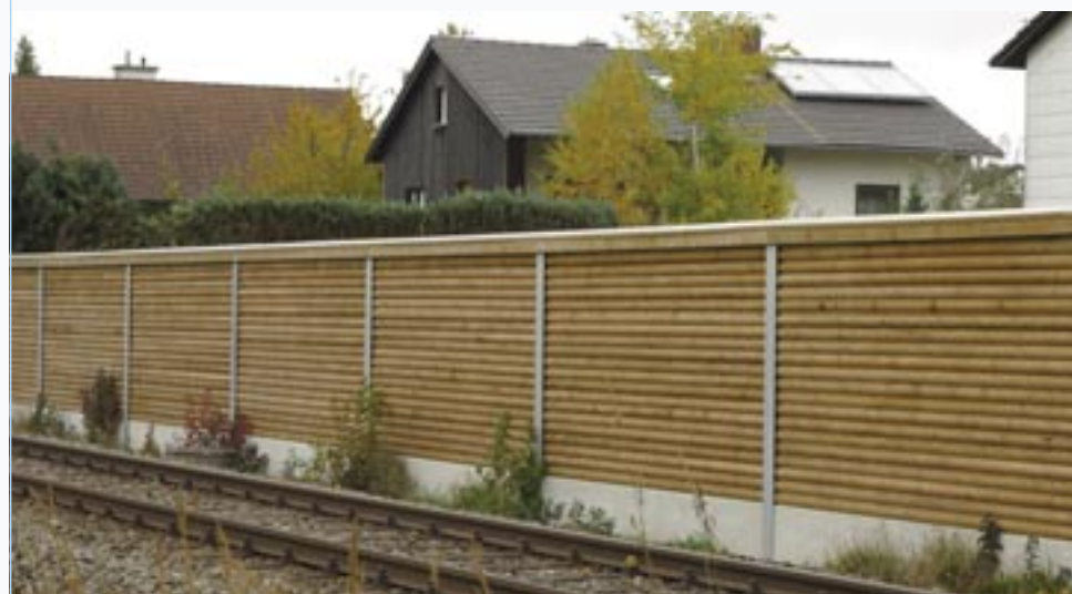
Reflektierende Rundholz-Lärmschutzwand Nr. 58.1 mit Abdeckdachl und Betonteil
