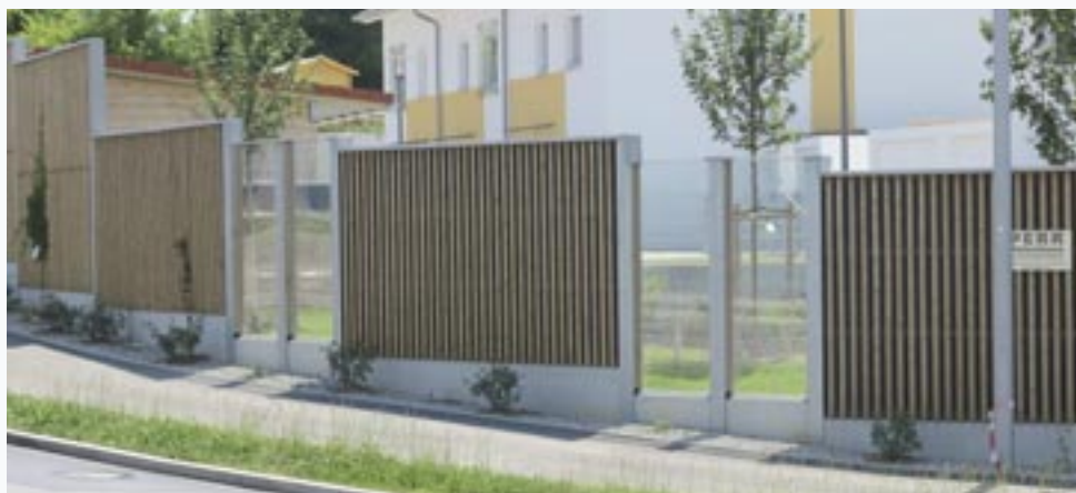
Hochabsorbierende Lärmschutzwand im Wechsel mit Glaselementen.
