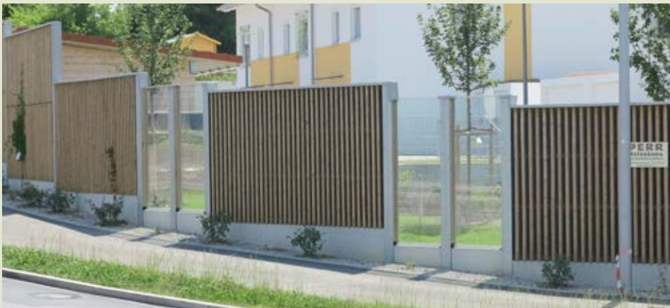
Hochabsorbierende Lärmschutzwand im Wechsel mit Glaselementen.
