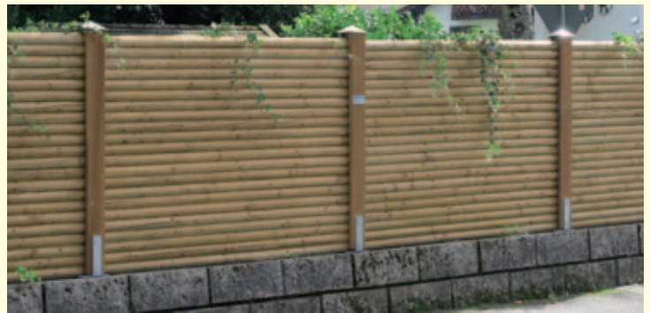
Sichtschutzzaun auf alte Mauer befestigt. An der Innenseite Wand mit 1 m tief einbetonierten HEA-Trägern stabilisiert.
