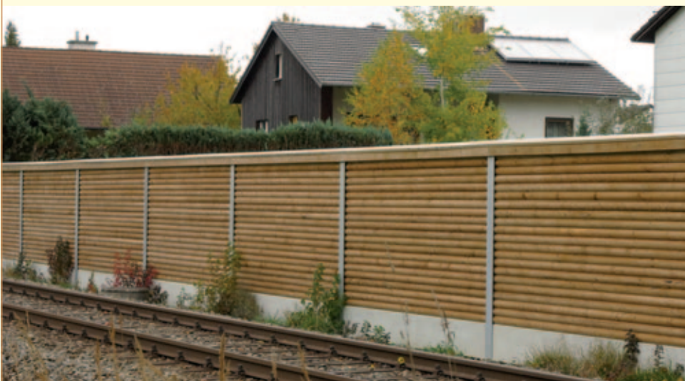
Reflektierende Rundholz-Lärmschutzwand Nr. 58.1 mit Abdeckdachl und Betonteil
